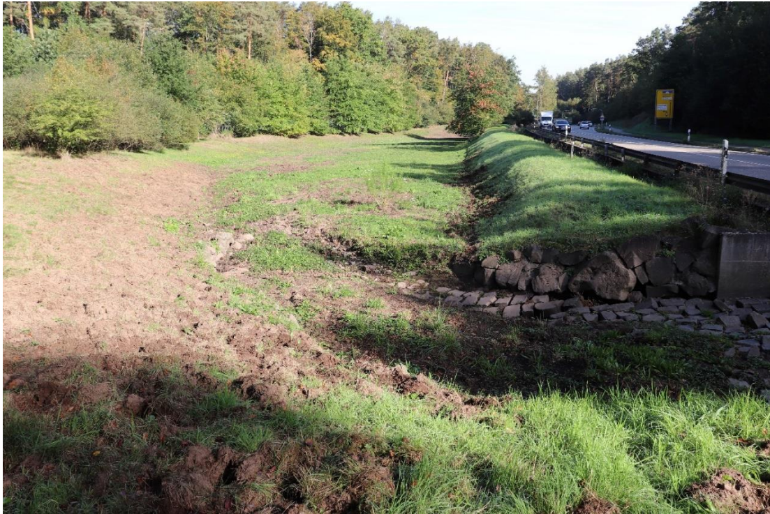
Abbildung 23: Rückhalteanlage für Straßenabflüsse und Außengebietszuflüsse
