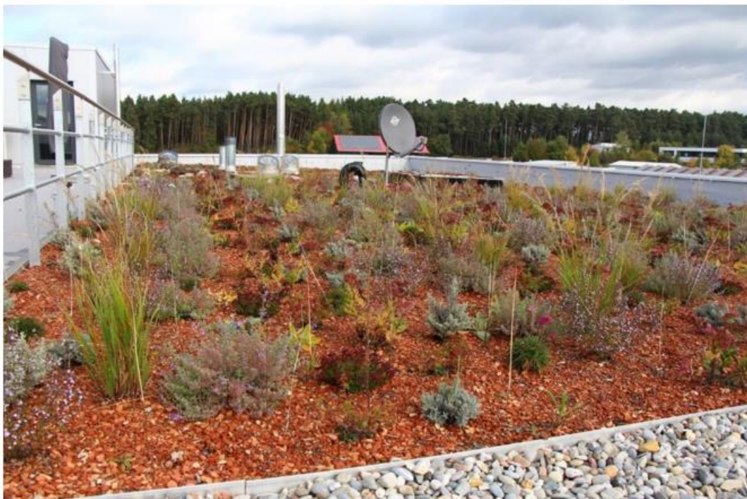
ABBILDUNG 67: DACHBEGRÜNUNG ALS EIN ELEMENT DER ENTWÄSSERUNG (FOTO: GÜNTHERT 2017)
