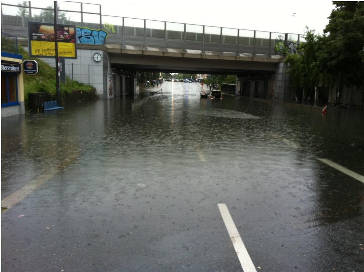
ABBILDUNG 22: ÜBERFLUTETE UNTERFÜHRUNG (FOTO: STADTENTWÄSSERUNG MÜNCHEN)
