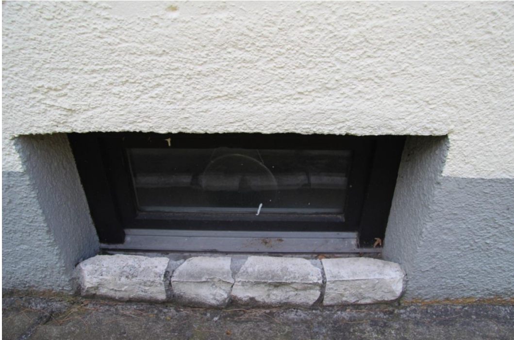
ABBILDUNG 64: GEMAUERTER SCHUTZ GEGEN OBERFLÄCHENWASSER VOR KELLERFENSTER (FOTO: GÜNTHERT 2015)
