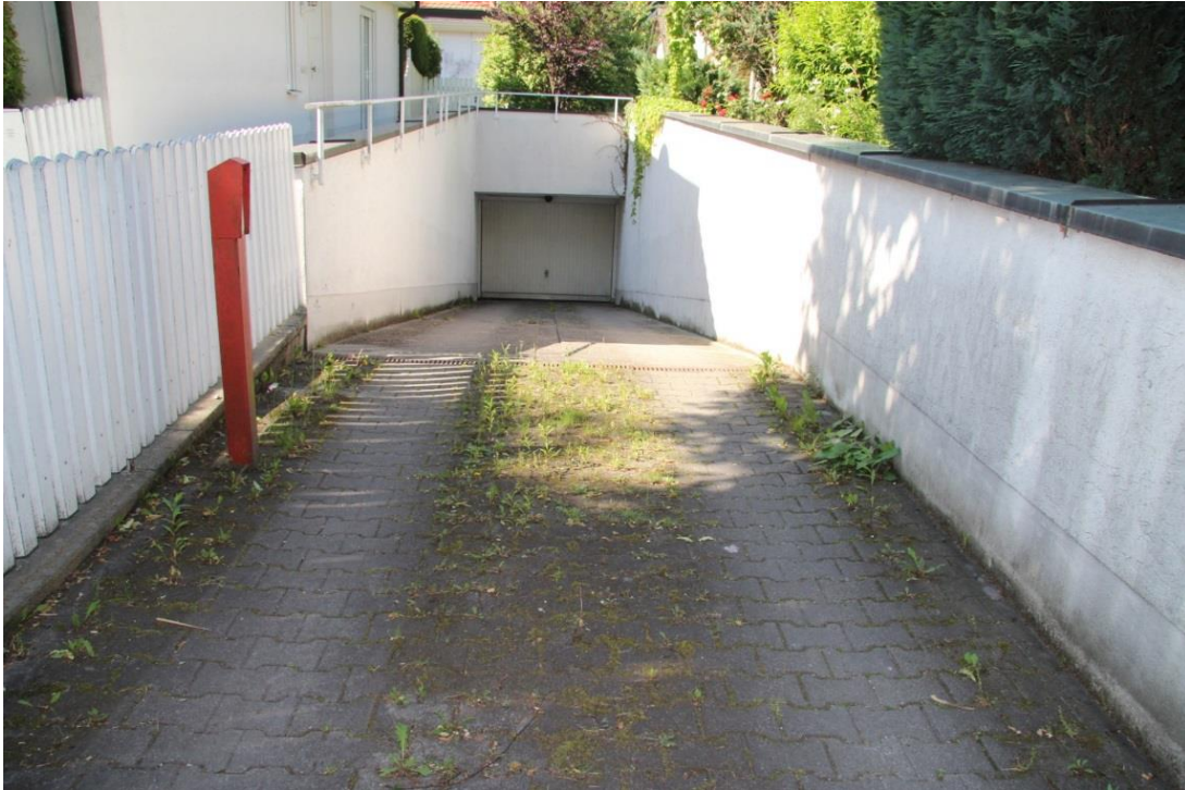
ABBILDUNG 61: GEFAHRENSTELLE TIEFGARAGENZUFAHRT (FOTO: GÜNTHERT 2015)
