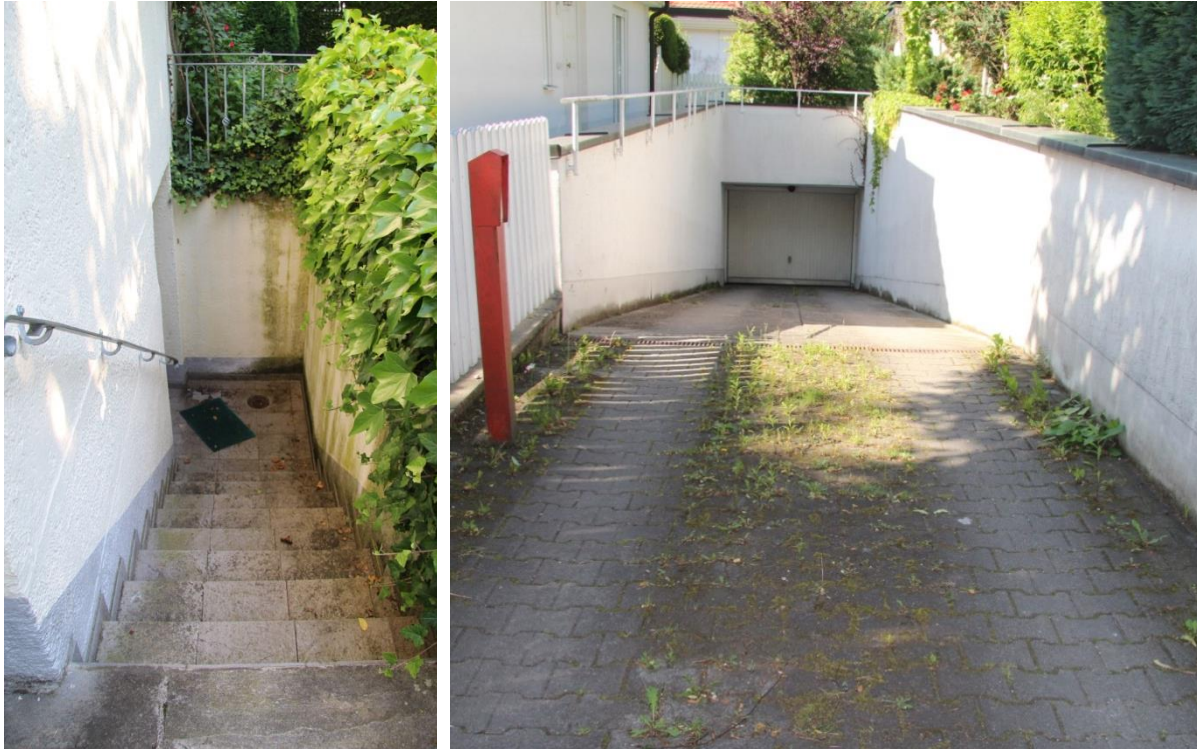
ABBILDUNG 18: GEFAHRENSTELLEN AN GEBÄUDEN. KELLEREINGANG (L) UND TIEF-GARAGENZUFABRT (R) (FOTOS: GÜNTHERT 2015)
