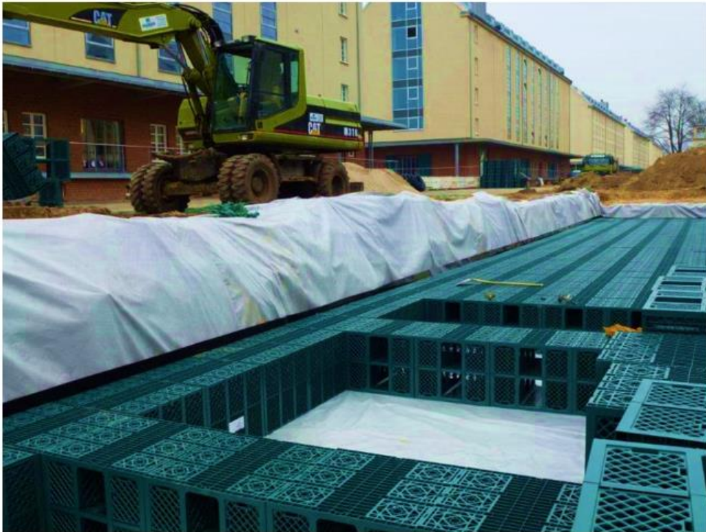
ABBILDUNG 66: RETENTIONS- UND VERSICKERUNGSANLAGE (FOTO: FRÄNKISCHE 2018)
